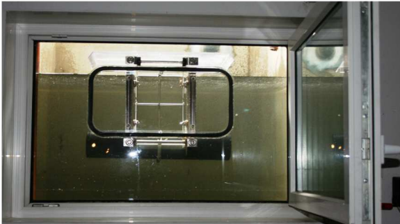
Automatisches Chiemgauer Hochwasserfenster: der Schwimmer geht nach oben - die Luke ist dicht!!
